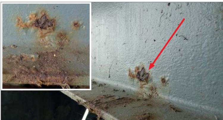
Rys. 5.3. Przykład dźwigara stalowego eksploatowanego mostu stalowego z uszkodzoną punktowo powłoką malarską powodującą powstawanie korozji wżerowej stali konstrukcyjnej
